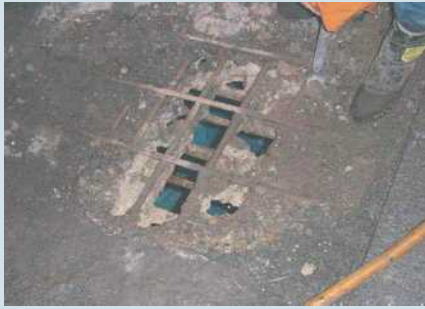
(橋の床版が損傷し抜け落ちた状況)
