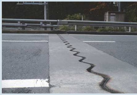
(橋の継ぎ目から漏水・段差)【山添橋】
